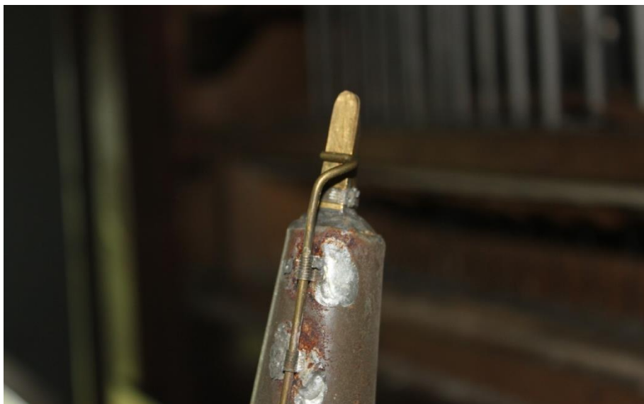
Guide per lo scorrimento delle grucce, prima del restauro, con evidenti problemi di ossidazione
