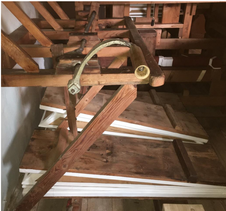
Le pompe restaurate
